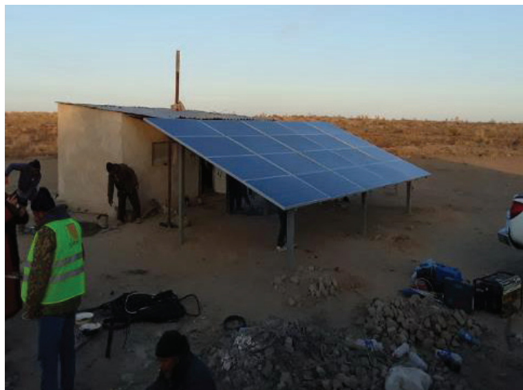
F) Solar panels
