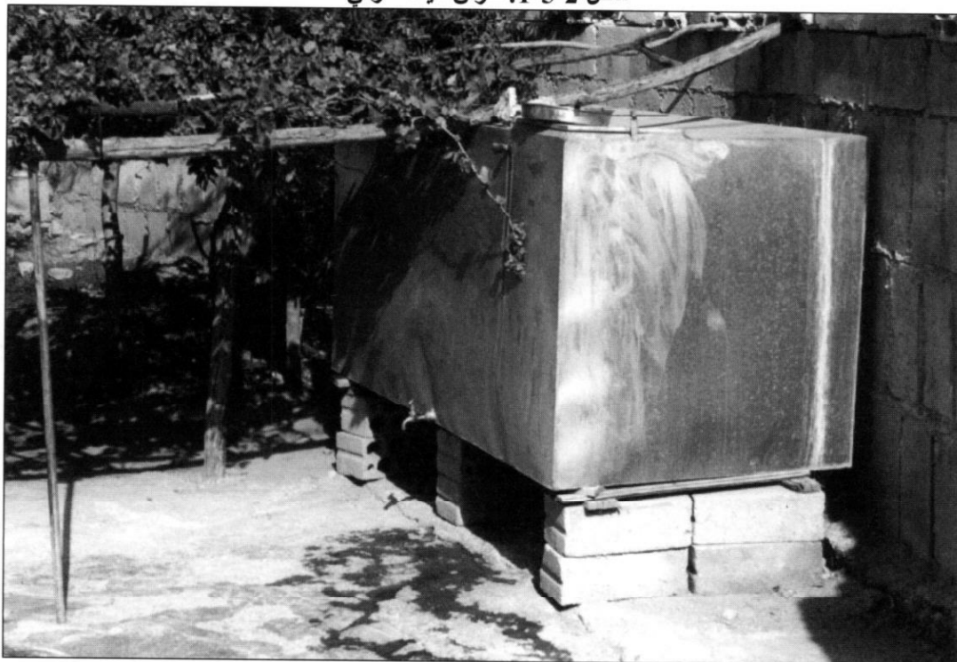
شكل 2-5-1: خزان مياه منزلي
