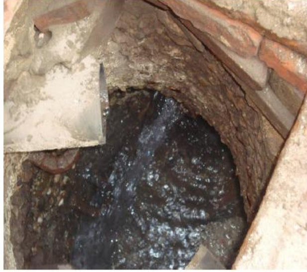
صورة رقم (٢) توضح امتلاء البلوعة من جميع الجوانب بمياه التسرب
