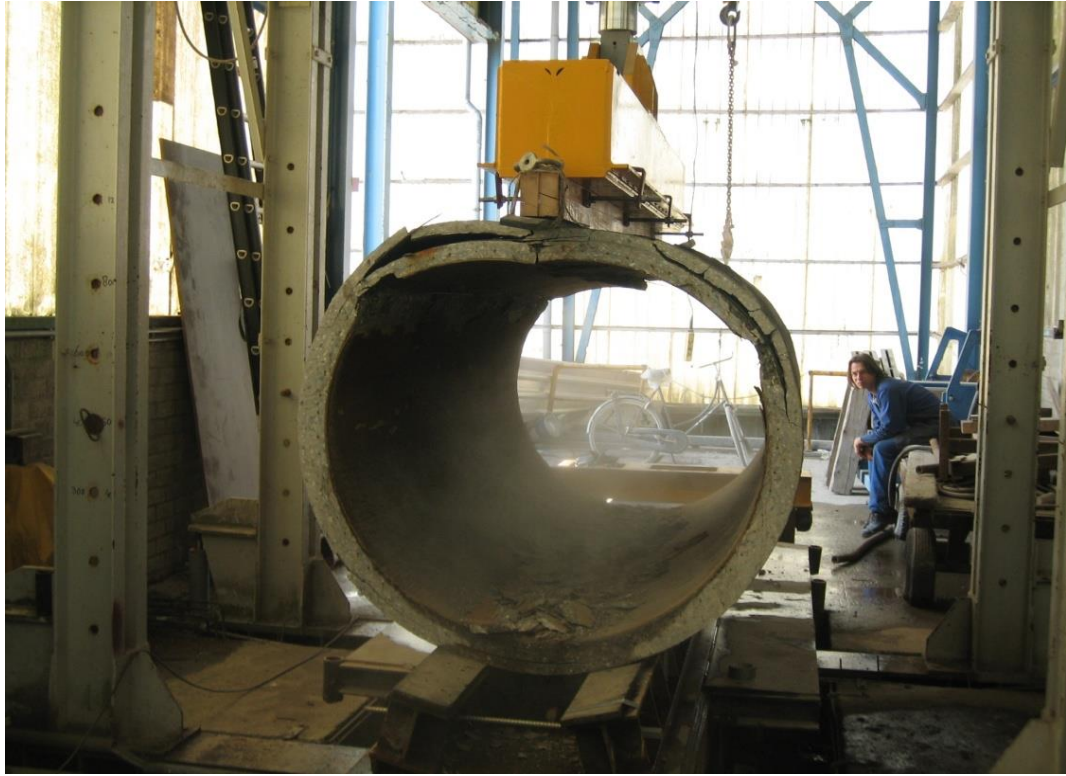
شكل يوضح التصدعات بخط مياه شرب
