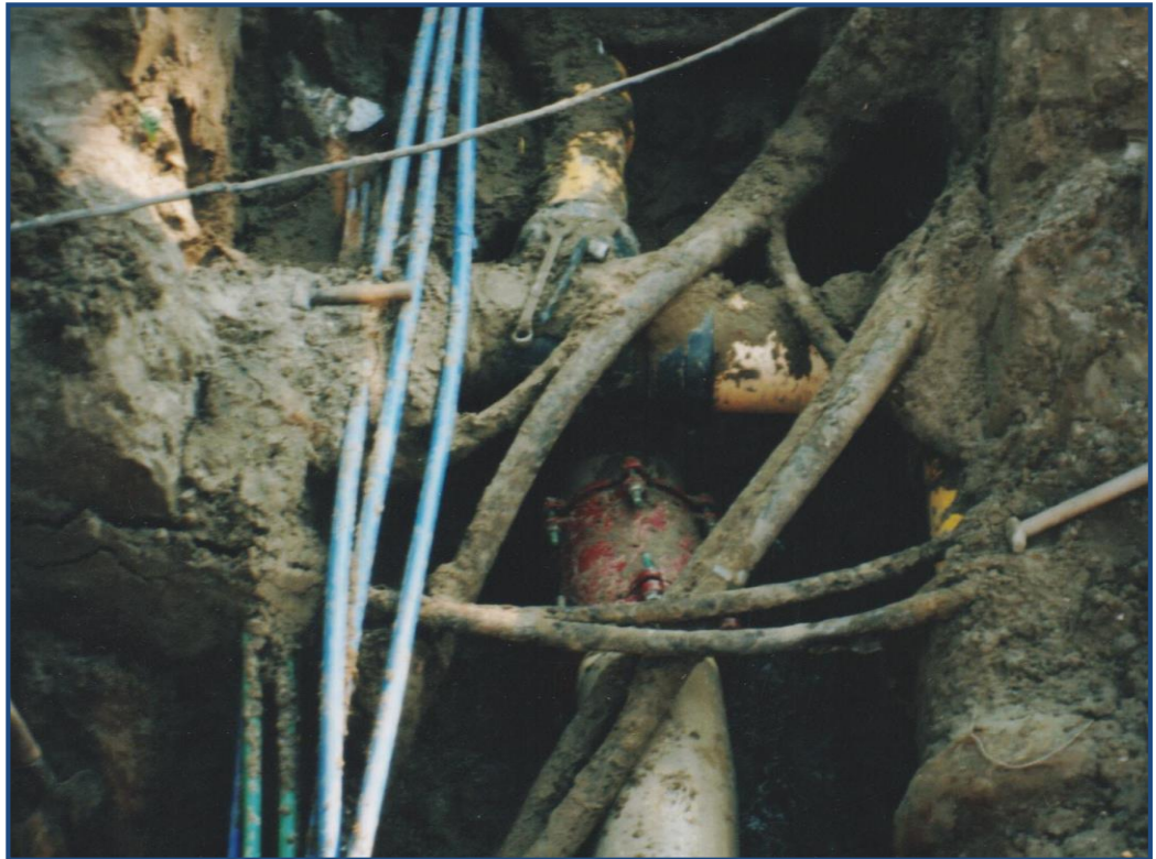
شكل يوضح المخاطر أثناء العمل بخطوط المياه
