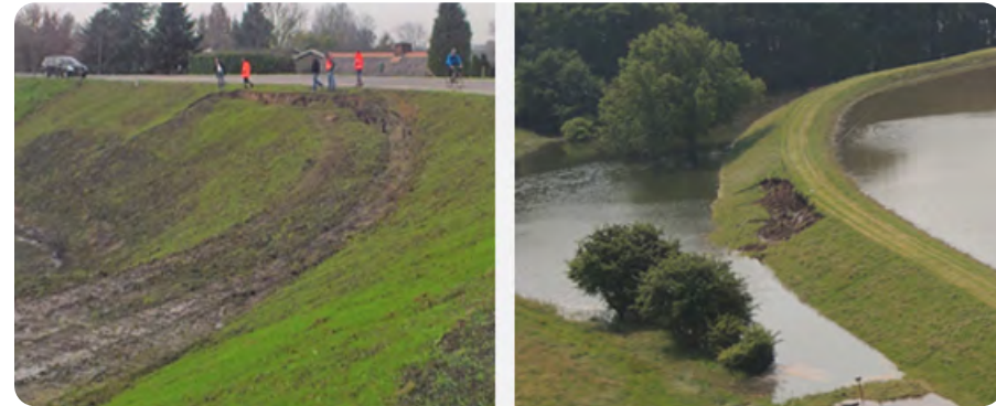
Figure 2: Examples of slope instability on the landward side with and without flooding due to dike breach. Sources: Landesbetrieb für Hochwasserschutz und Wasserwirtschaft Sachsen-Anhalt (LHW) and Jüpner et al. (2015) .
