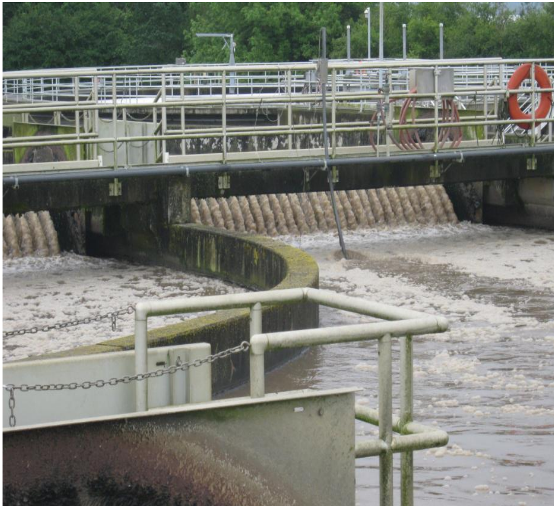
يوضح الشكل رقم (٢-٥) وجود رغاوى بيضاء نتيجة انخفاض MLSS وزيادة F / M وانخفاض عمر الحمأة بالمحطة
