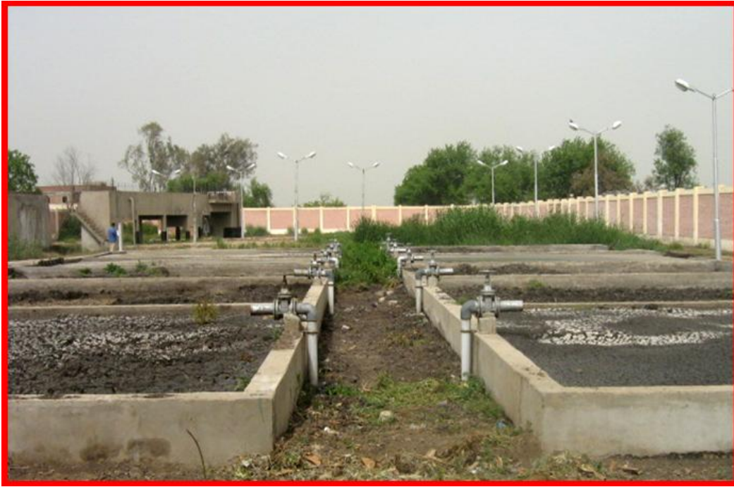
أحواض تجفيف الحمأة
