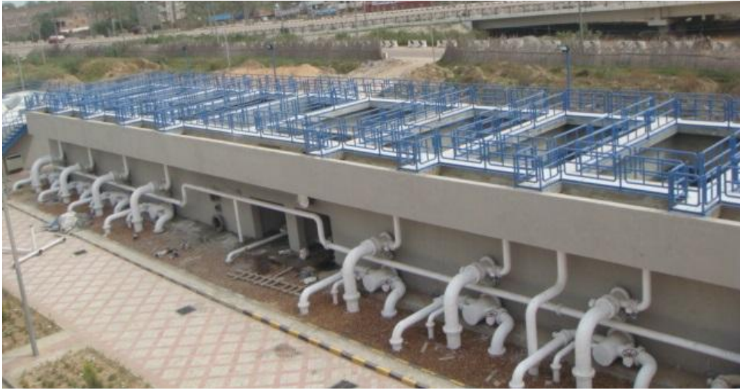
محطة ترشيح مباشر
