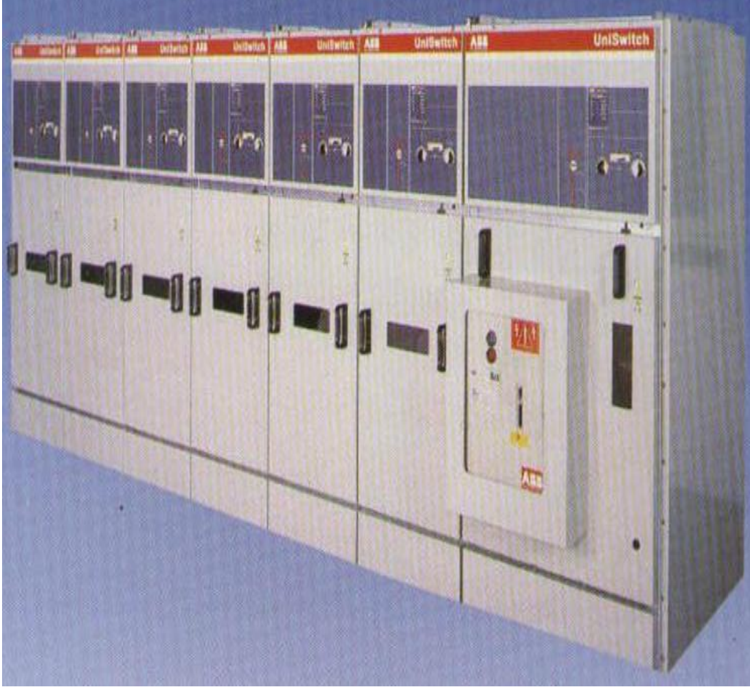
لوحة توزيع جهد متوسط داخل مبنى
