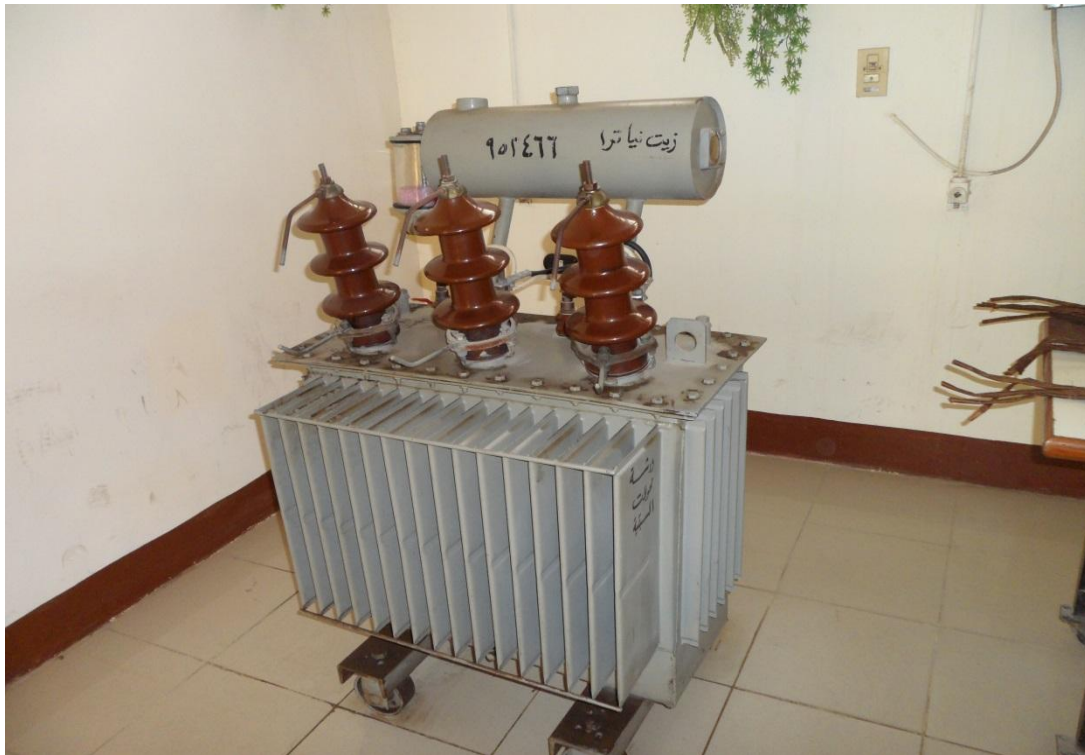
محولات تركيب داخل المباني
