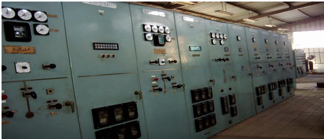
لوحة تشغيل محركات جهد متوسط ٣/٣ ك.ف داخل مبنى
