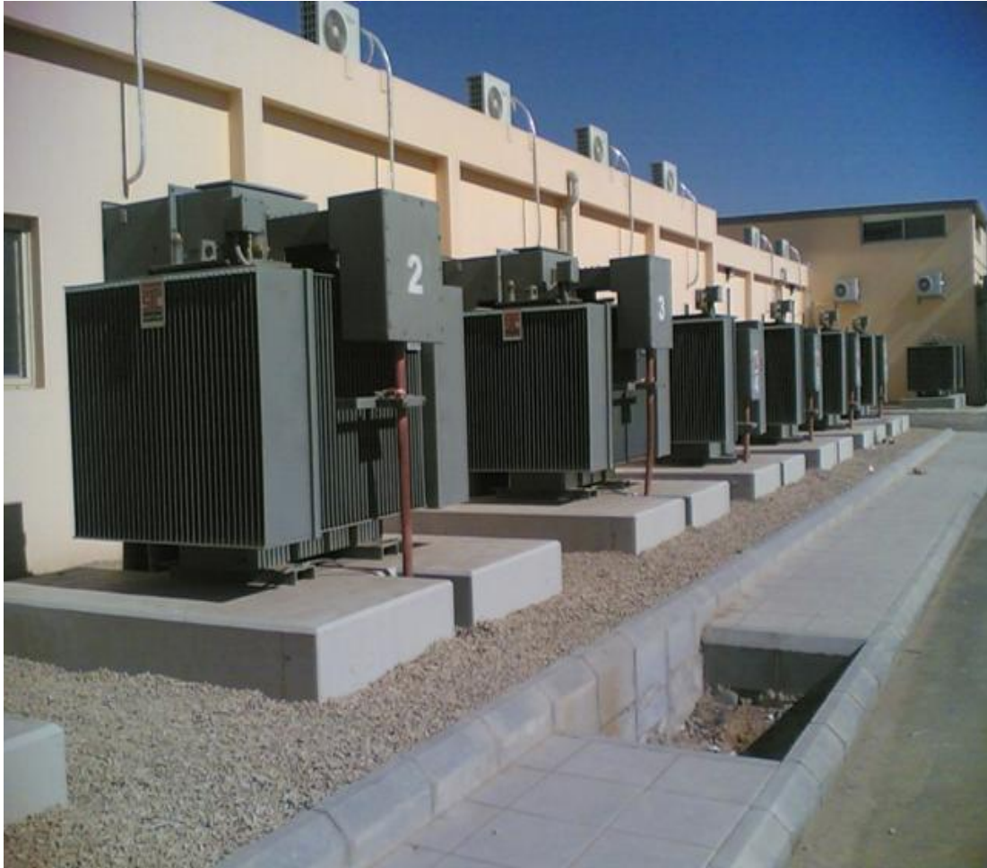
محولات تركيب خارج المباني
