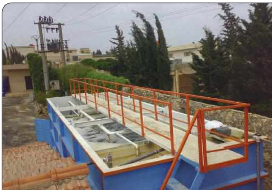
الشكل (1-1-3-71-26) محطة معالجة بالحمأة المنشطة مع ترسيب كيميائي في معمل منظفات فتوح
