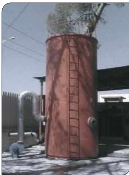
الشكل (1-2-1-6-30) صورة لمرشح التنقيط في معمل المشروبات الغازية
