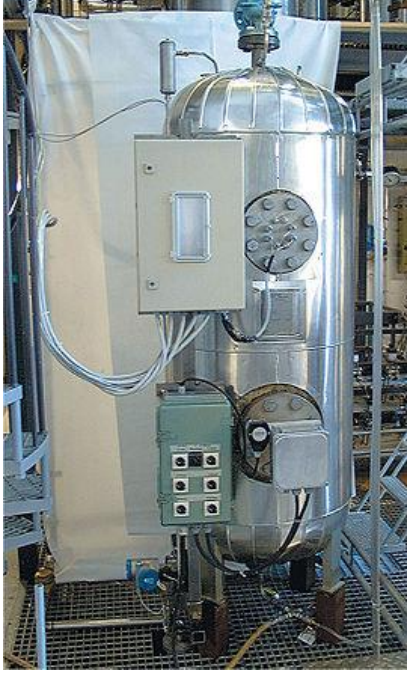
الشكل (١٢-٤٨) خزانات الضغط
