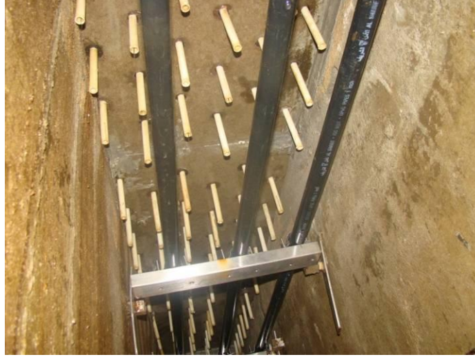
مواسير توزيع الهواء اسفل قاع المرشح ١
