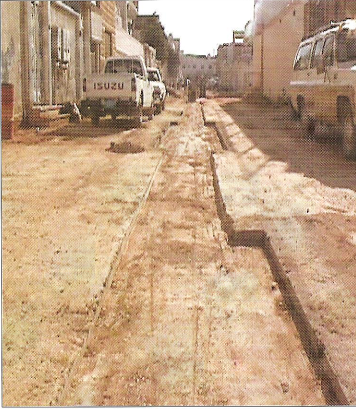
الشكل رقم ٦-٣ عدم جاهزية الأعمال الترابية-حالة عدم استواء وسوء الدك
