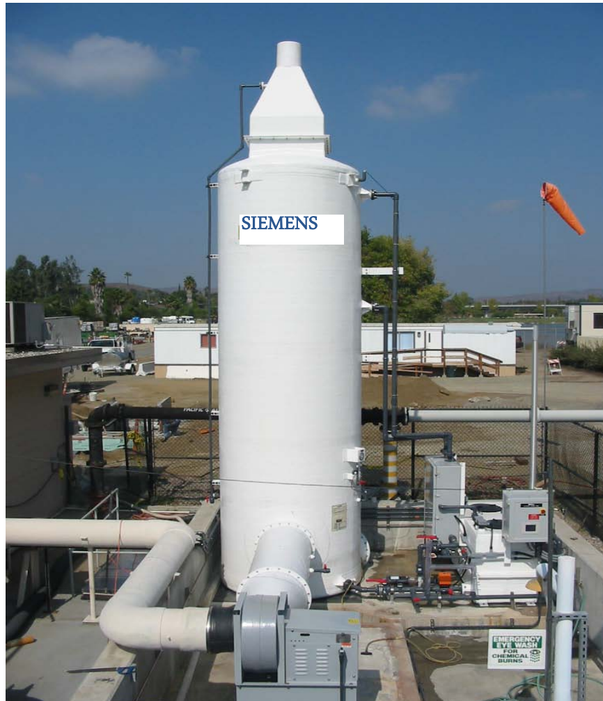
Padre Dam WWTP 3,400 m 3 /h
