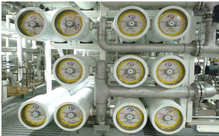
Membranes d'osmose inverse
