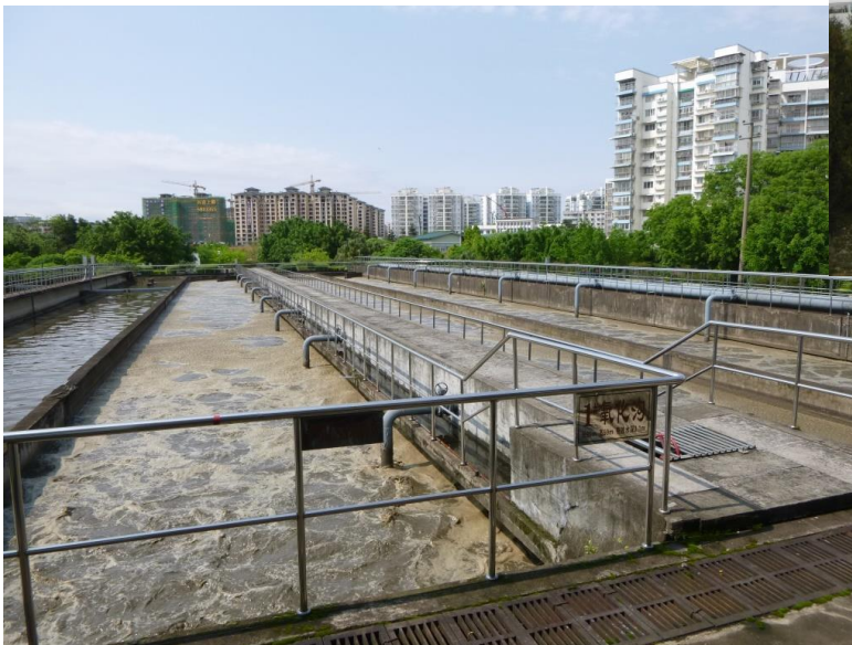
Qilidian WWTP (China)
