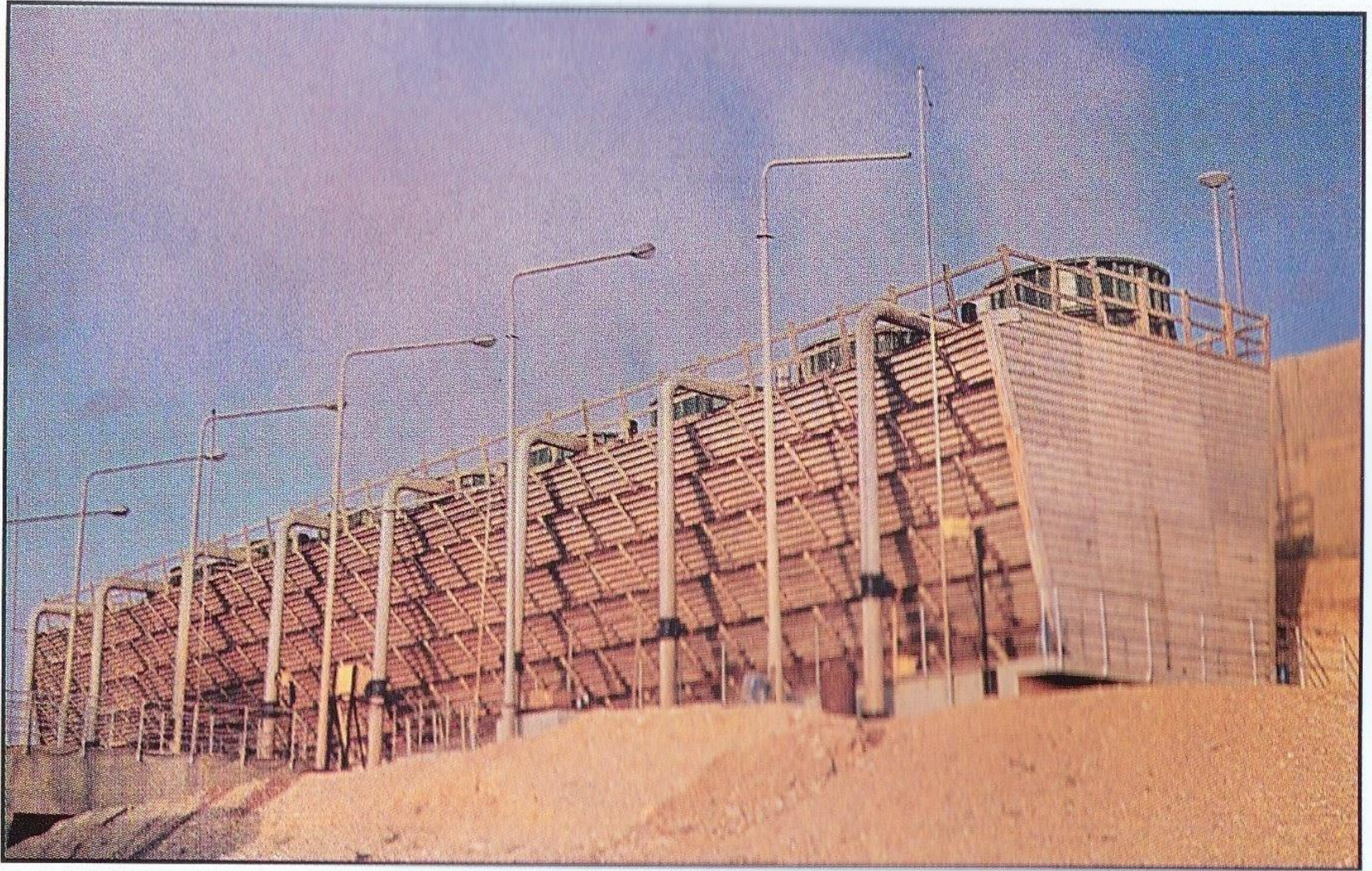
● جانب من وحدات التبريد بمحطة مياه صلبوخ
