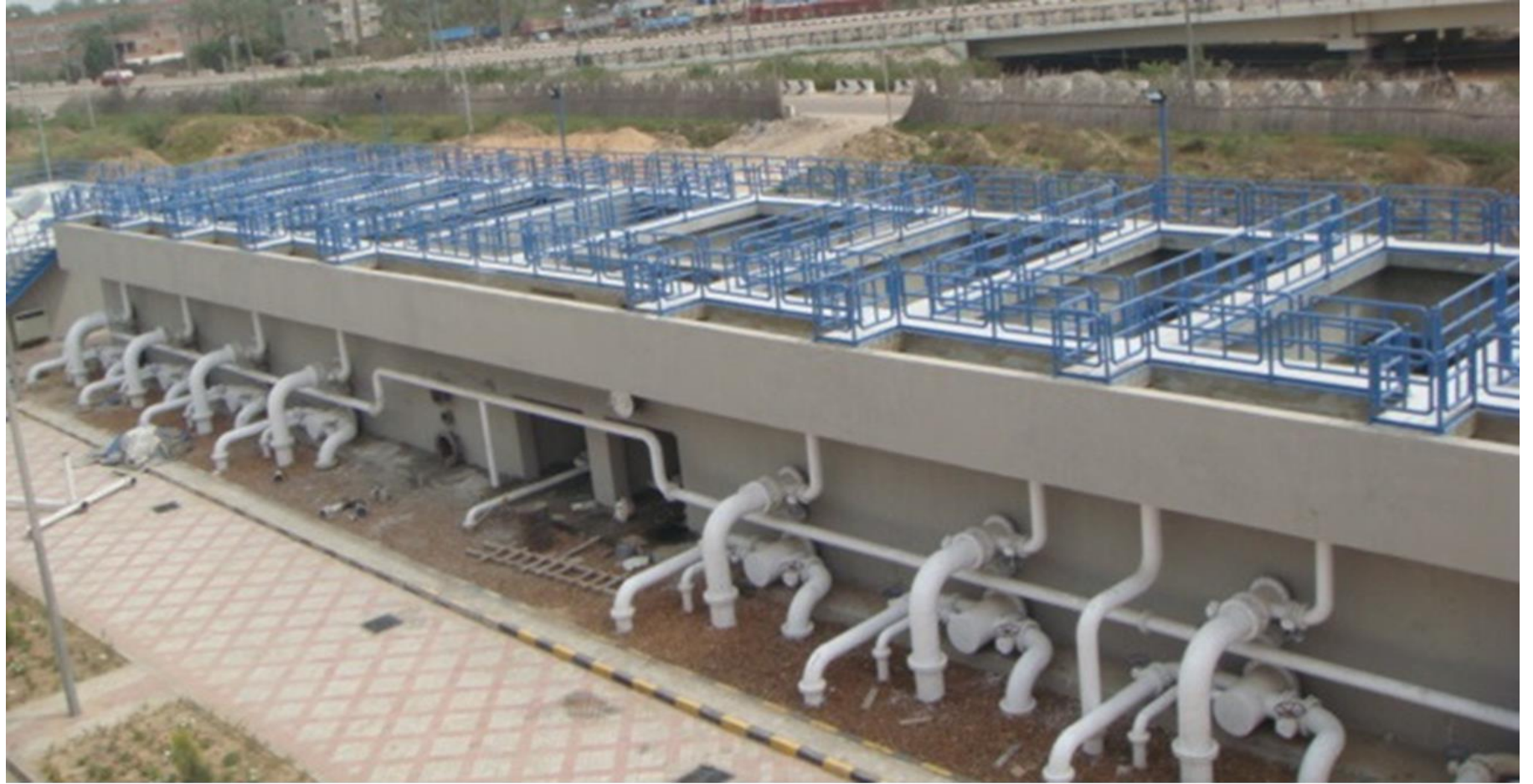
محطة ترشيح مباشر
