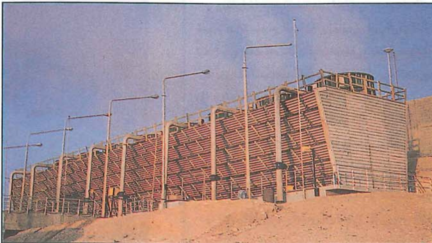
● جانب من وحدات التبريد بمحطة مياه صلبوخ
