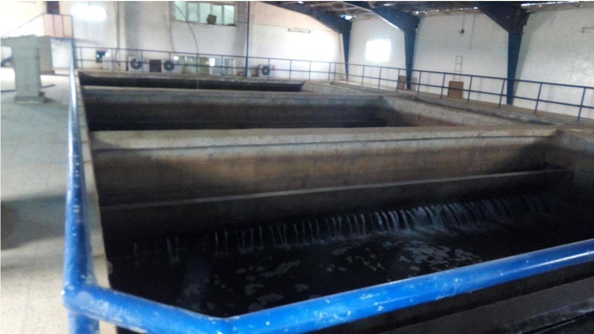
ملحق (4) المرشحات الرملية للمحطة الجديدة
