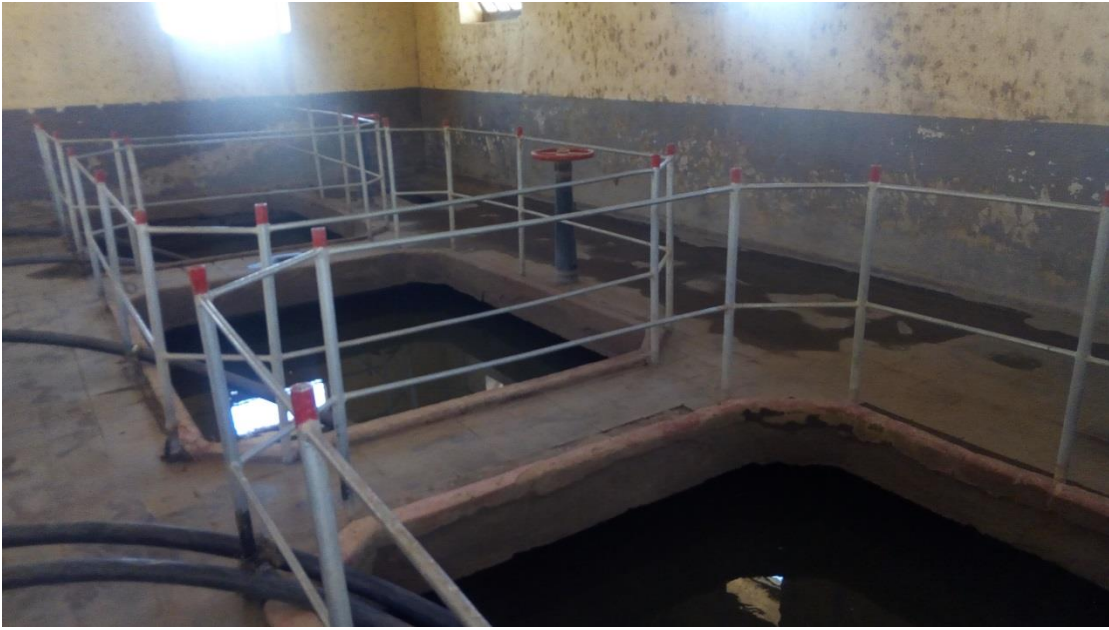
ملحق (5) المرشحات الرملية للمحطة القديمة
