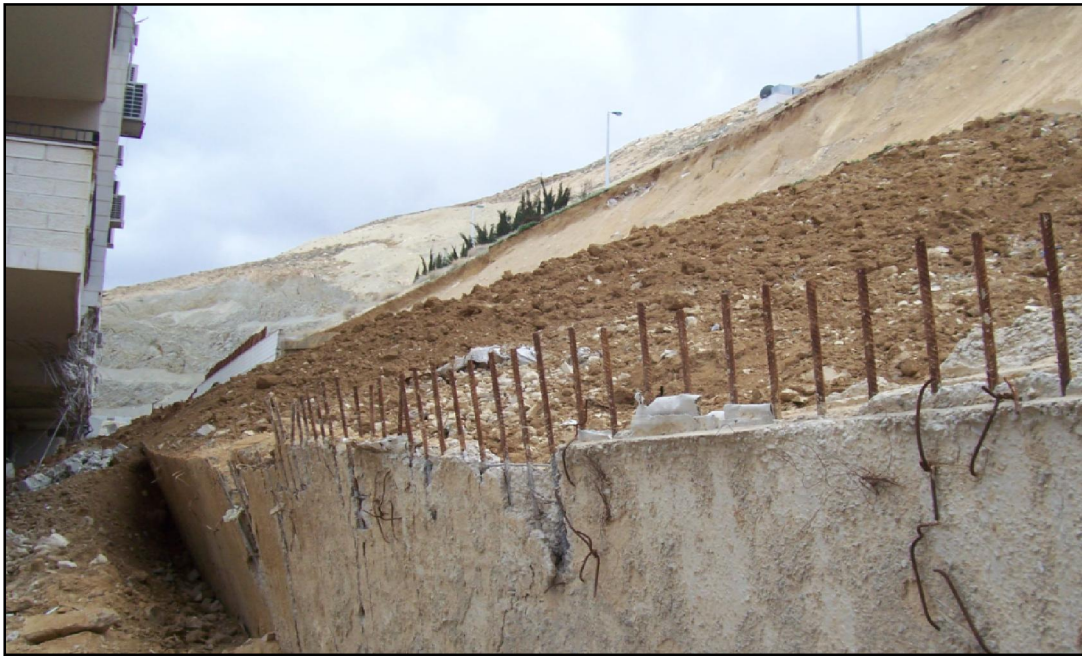
الشكل (9.1) . انهيار منحدر بجوار مبنى نفذ فيه جدار استنادي ضعيف
