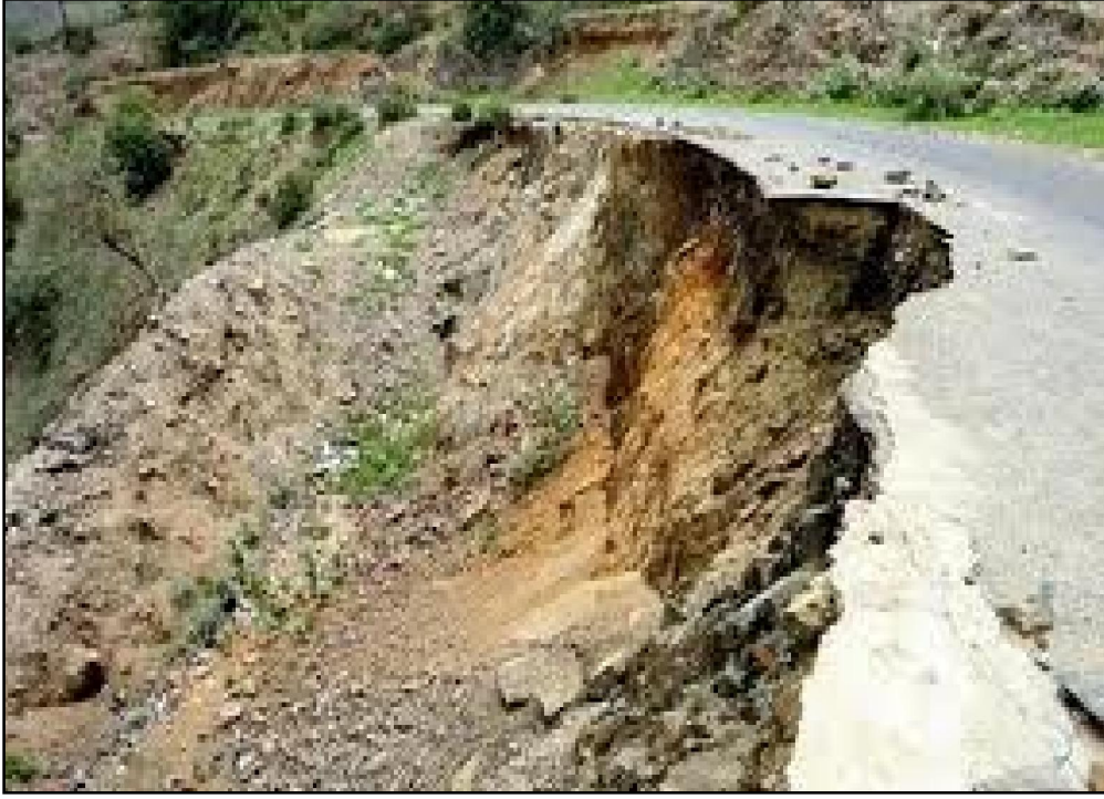
الشكل (6.1) . انهيار منحدر ترابي بجوار طريق جبلي
