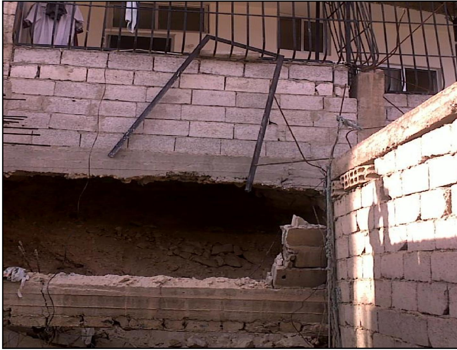
الشكل (8.1) . انهيار منحدر تحت مبنى قائم
