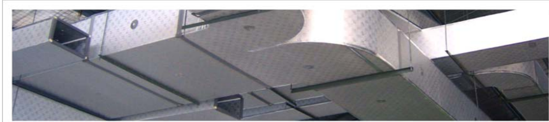
الشكل 1.3 مجرى الهواء مسبق العزل
