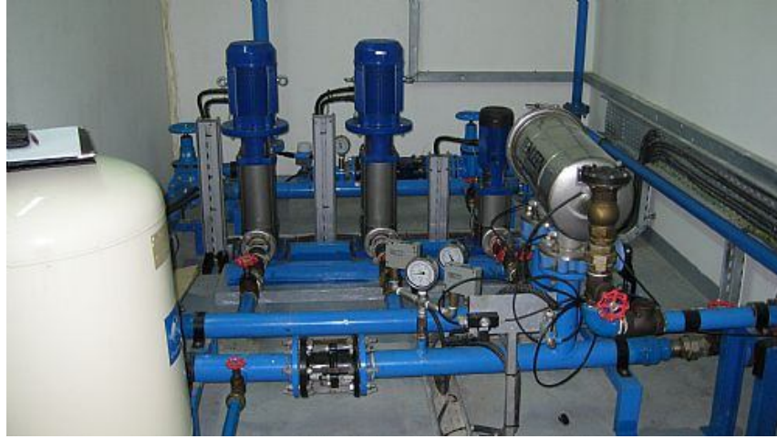
صورة رقم (١) وحدة رأس في غرفة مضخات
