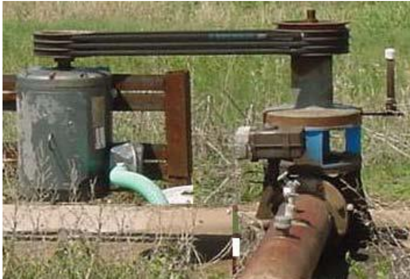
الشكل (19.1) مضخة مربوطة على محرك كهربائي
