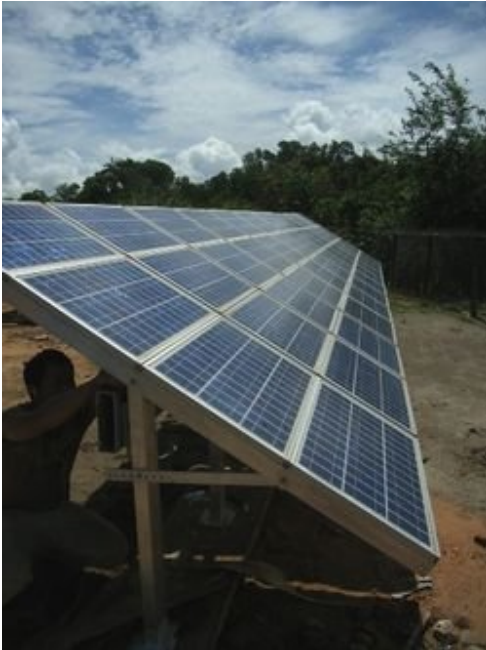
Solar PV array
