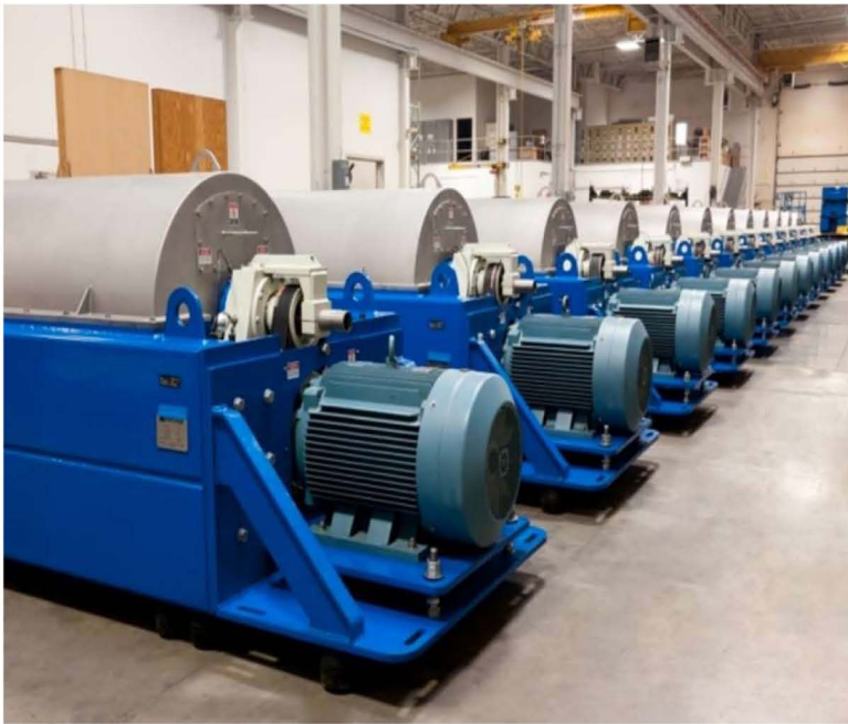
الشكل (5-11): يظهر محطة نزع المياه من الحمأة بطريقة الطرد المركزي أو النبذ
