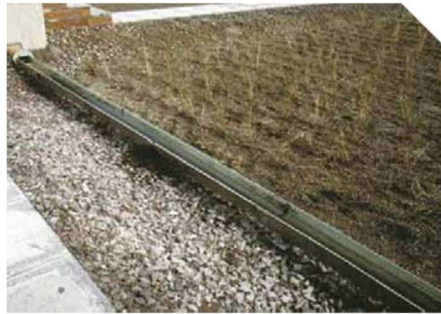
مدخل مياه الصرف على شكل قناة مكشوفة
