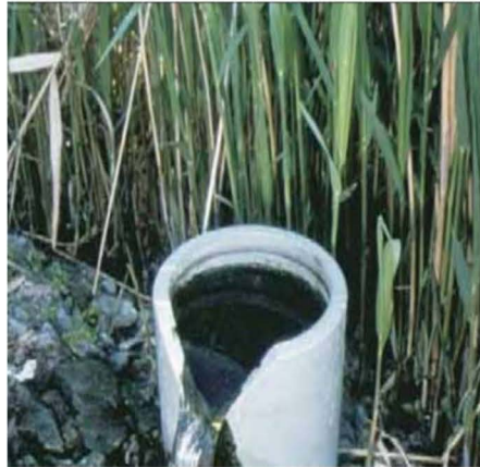
مدخل مياه الصرف على شكل أنبوب مرفوع
