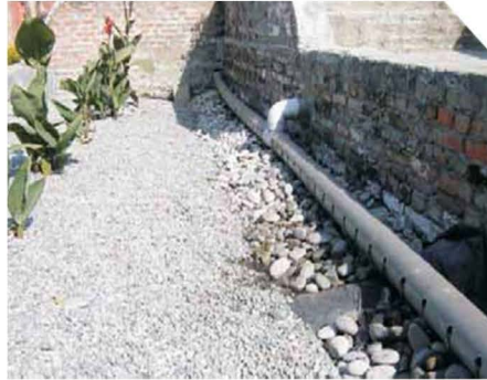
مدخل مياه الصرف من الأنابيب المثقبة
