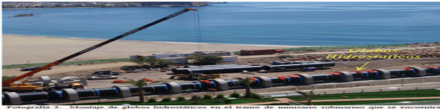
Fotografía 3. Montaje de globos hidrostáticos en el tramo de tunisario submarino que se encuentra construido en la "lanzadera".
