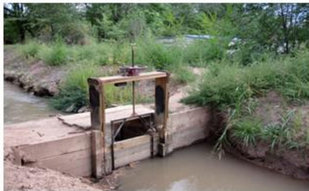
Fig. 14.1. Canal check gates.
