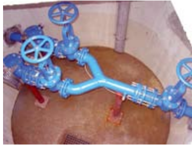
Fig. 4.1.1.2 a: Valve pit
