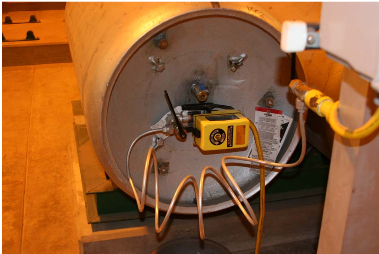
A 1 ton chlorine container.
