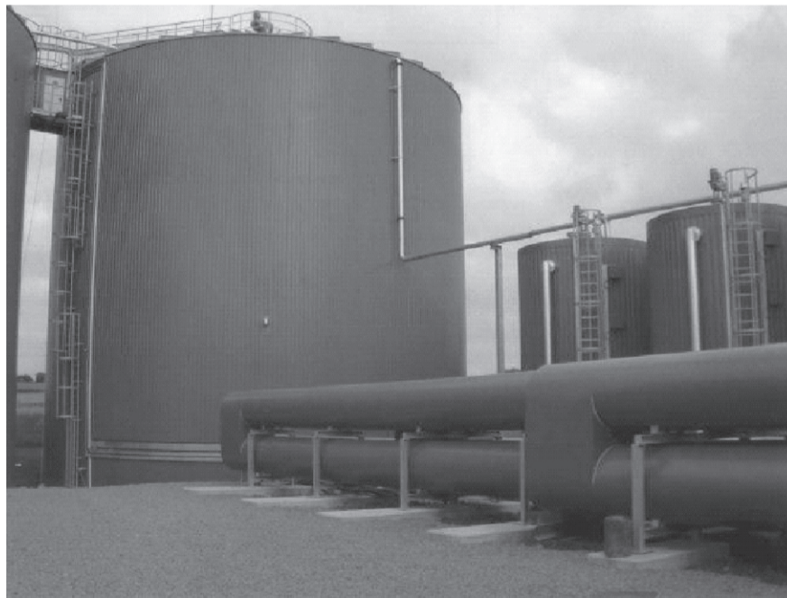
Fig.: 8.7 Anaerobic Digester
