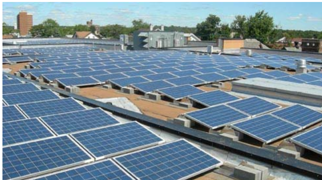
120kW PV Array
