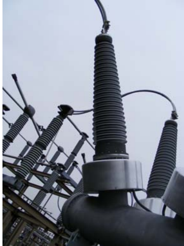
Fig. 19. 230 kV 2000/5 A Bushing CT
