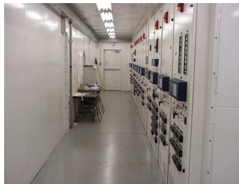
Fig 24. 4 kV Switchgear (Inside)
