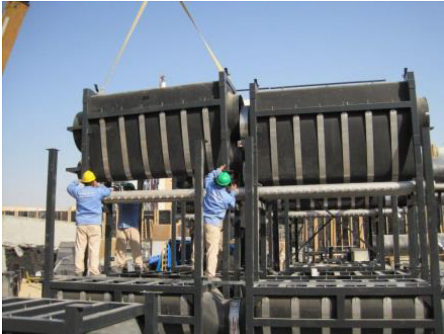
King Faisal Hospital (KSA) XX m 3 /h
