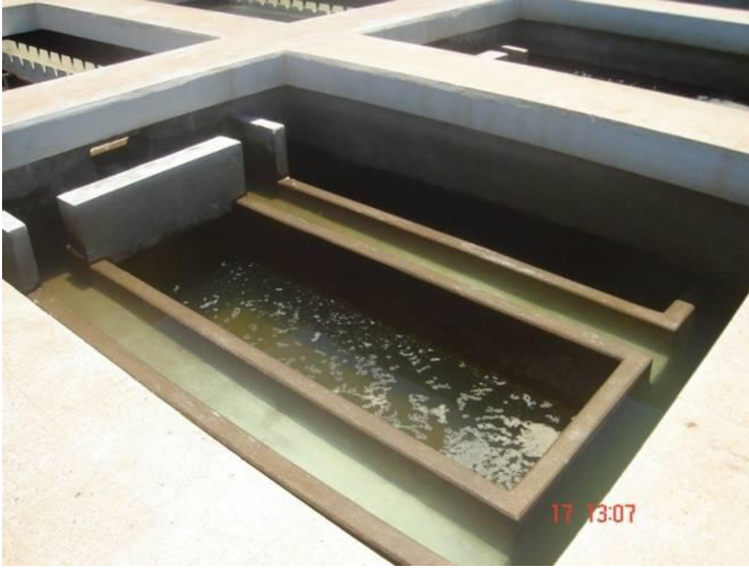
الترشيح المباشر - دمياط
