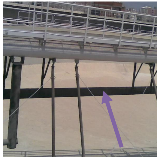
كاشطة (جرافات) سفلية (حمأة خام – حمأة نشطة -روبة)
