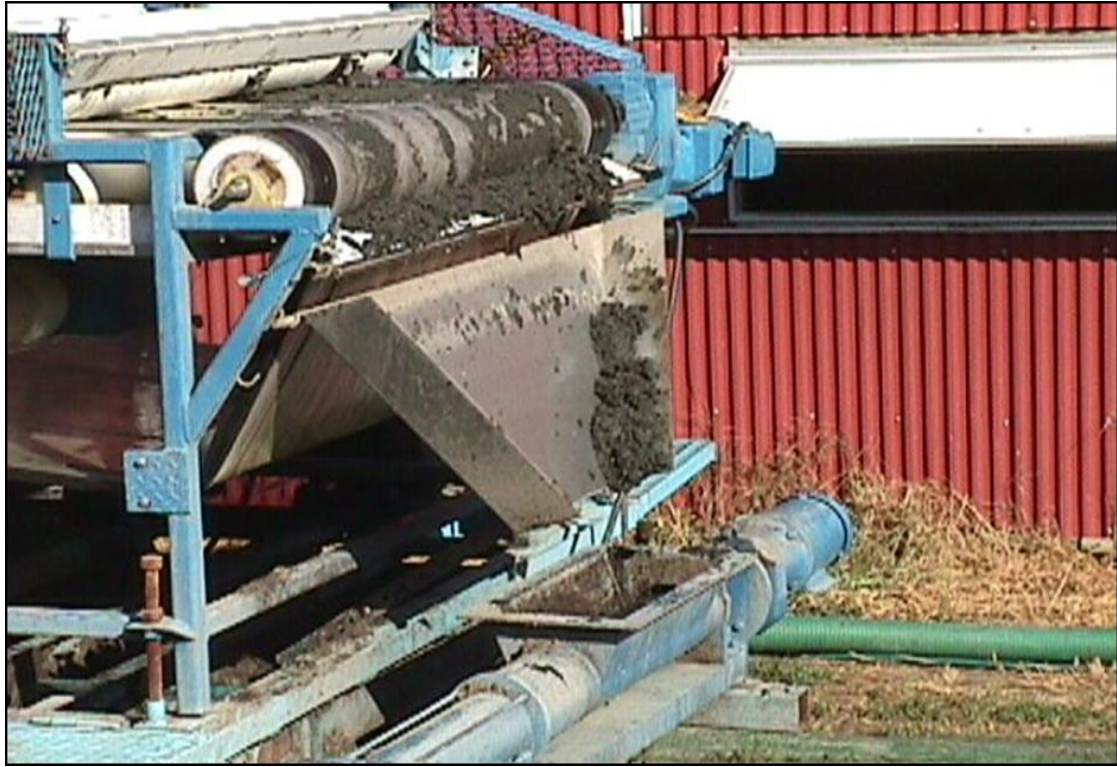
شكل رقم (١٤) ماكينة تجفيف الحمأة باستخدام سيور الترشيح الضاغطة
