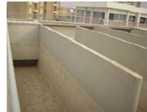
ظلميات البوستر وأحواض تلامس الكلور
