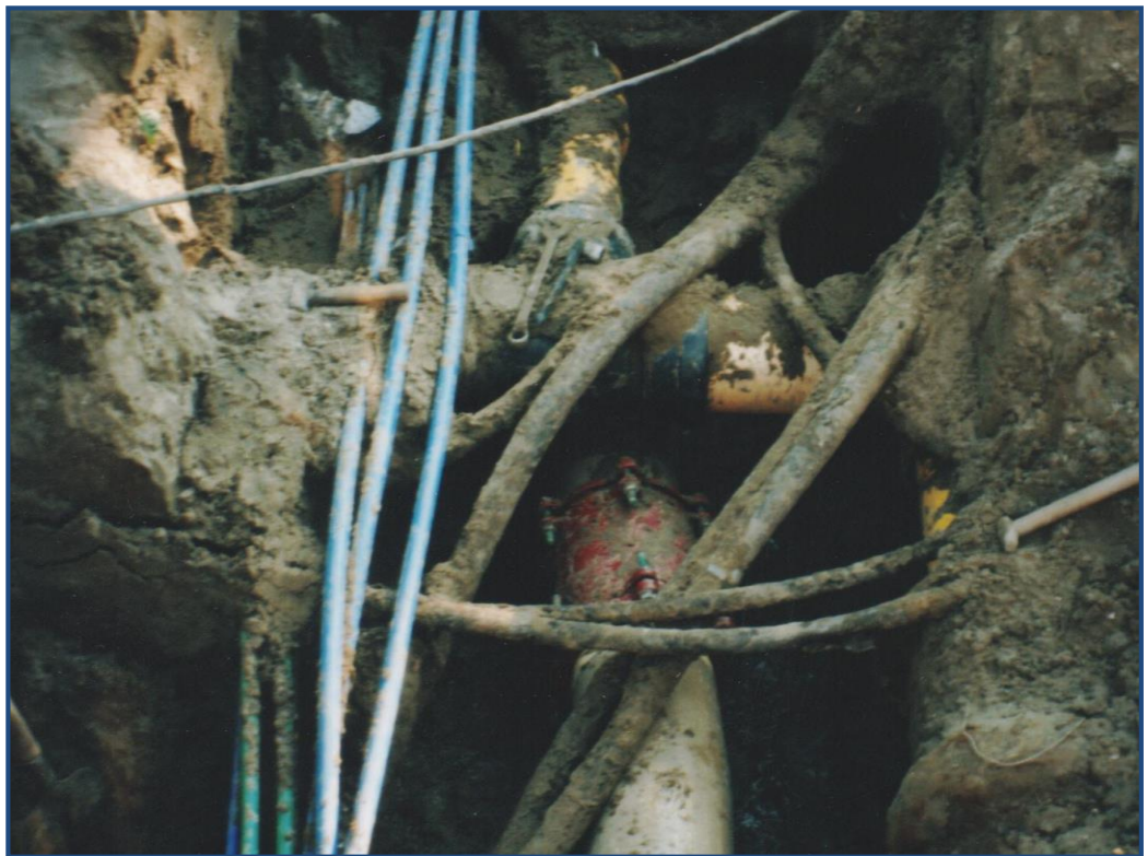
شكل يوضح المخاطر أثناء العمل بخطوط المياه
