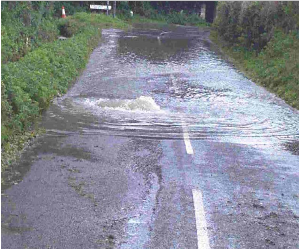
طفح مياه الصرف الصحي نتيجة لانسداد الشبك
