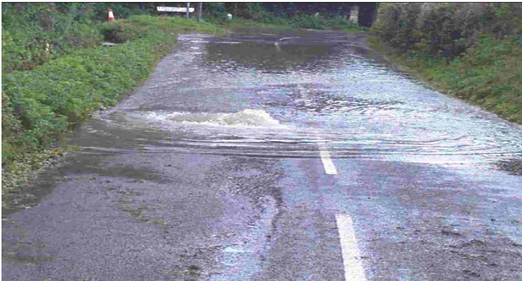
طفح مياه الصرف الصحي نتيجة لانسداد الشبكة
