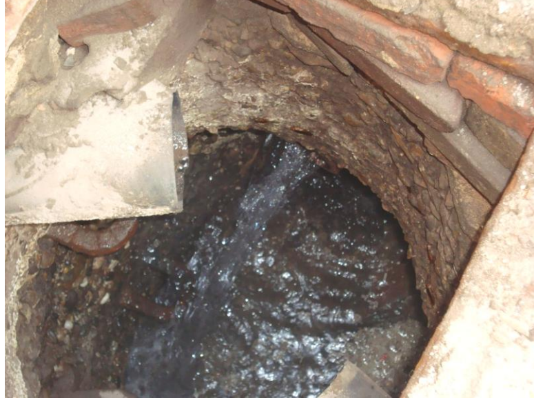
صورة رقم (٢) توضح امتلاء البلوعة من جميع الجوانب بمياه التسرب
