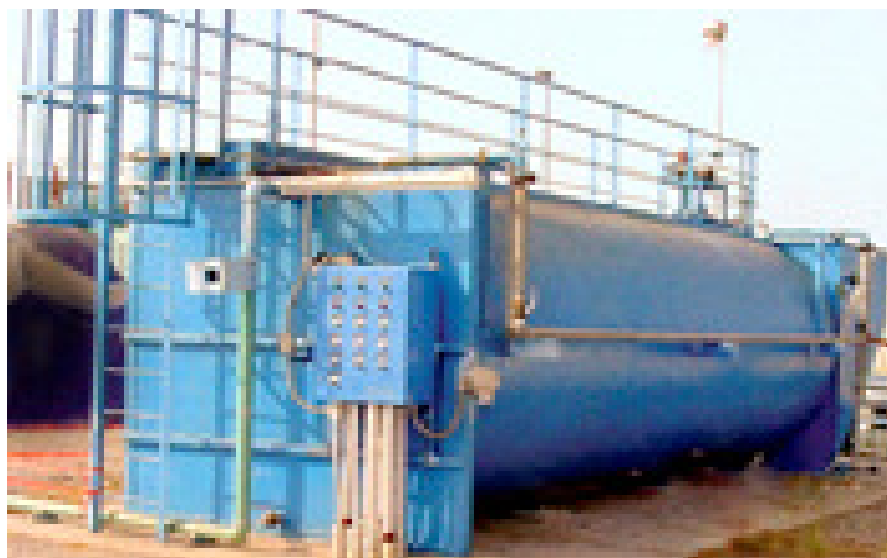
وحدة معالجة مياه الصرف الصناعي
