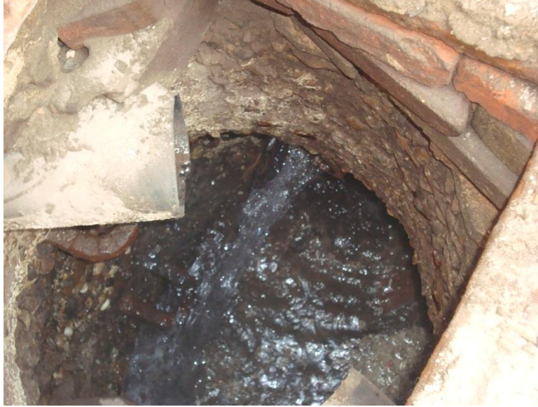
صورة رقم (٢) توضح امتلاء البلوعة من جميع الجوانب بمياه الشرب
