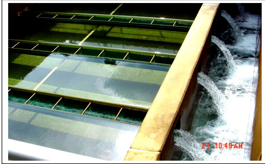
شكل رقم (١٨) المرشح الرملي السريع اثناء عملية الغسيل
