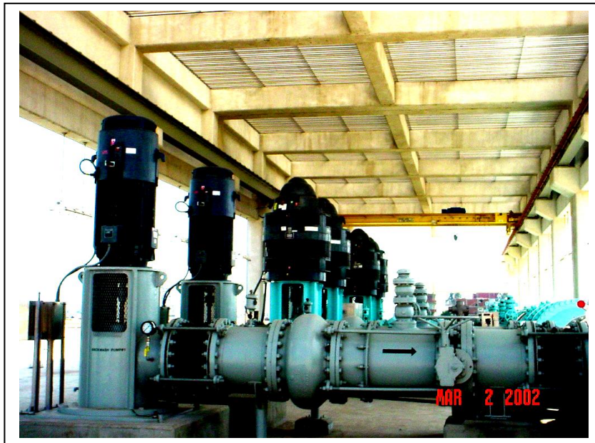
شكل رقم (٢٠) ظلمبات المياه المرشحة
