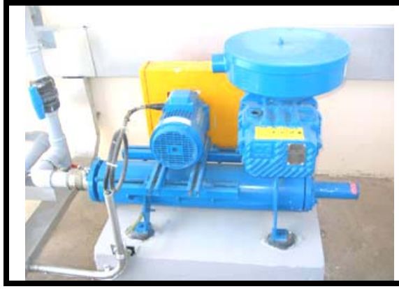
شكل (٤-٣) صورة لضاغط الهواء
