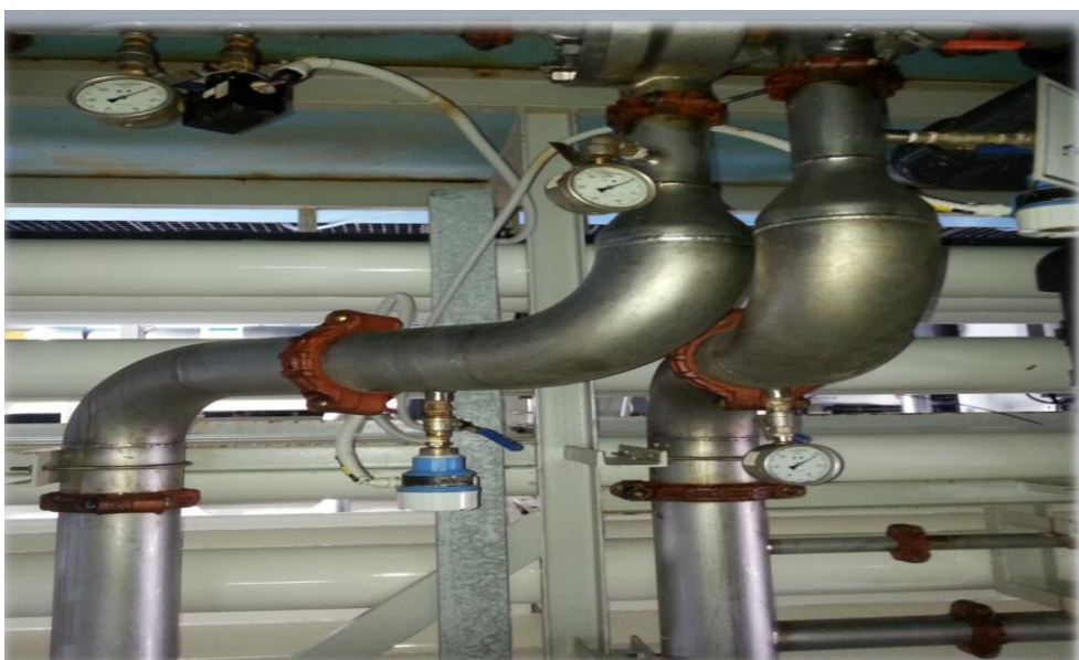
وحدة رفع ظلمبات الضغط العالي عن طريق الريجيكيت
