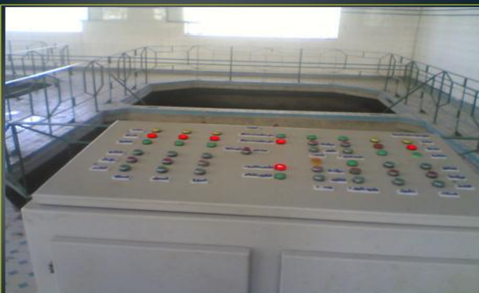
وحدة التحكم بالمرشح
