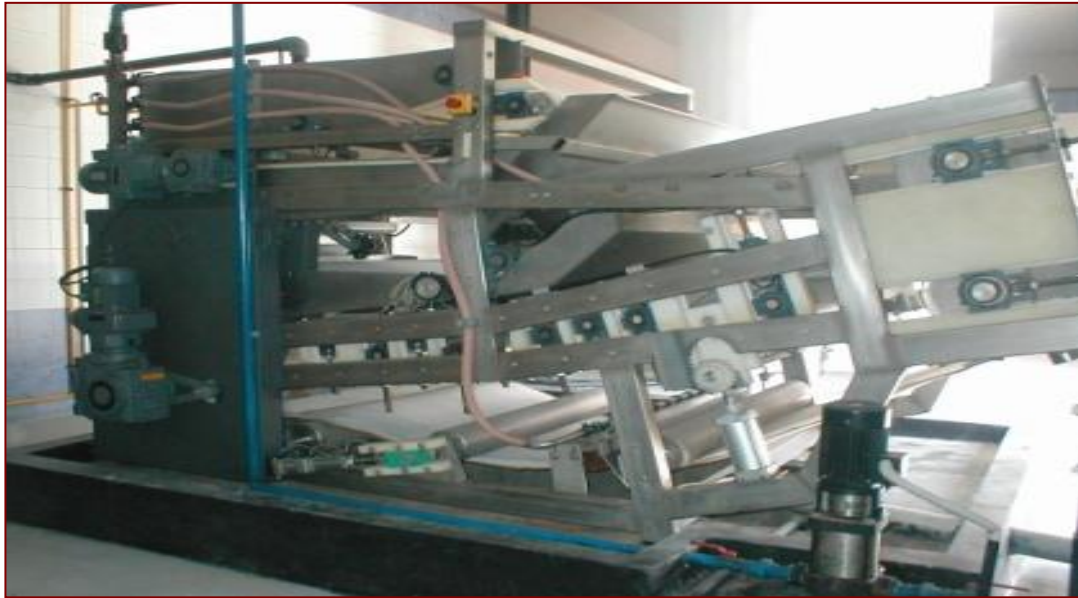
شكل رقم 14 ماكينة تجفيف الحمأة باستخدام سيور الترشيح الضاغطة
