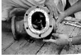
فحص القاعدة الجلدية ومعدن القاعدة الحلقية
