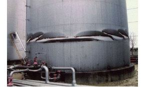
(d) Diamond pattern buckling of tank wall
